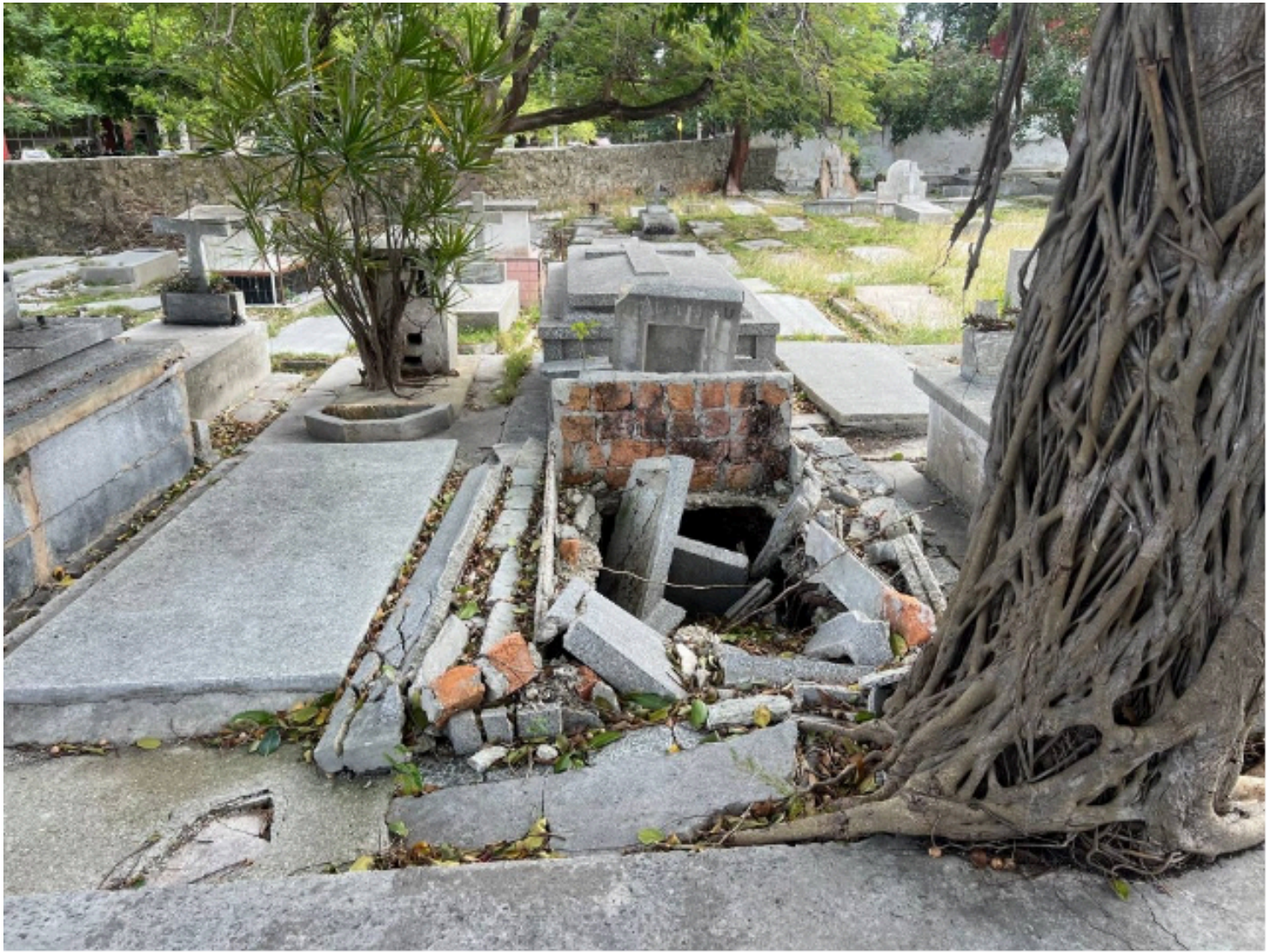
Deterioro debido a la maleza y las raíces de los árboles. Imagen: archivo ODC.
